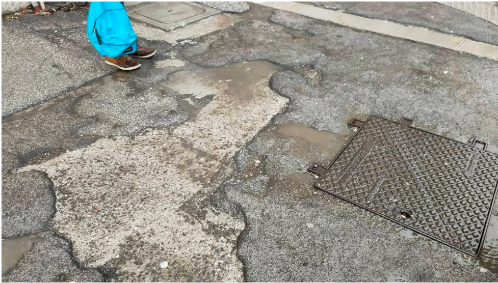
Condizioni del marciapiede sul lato pari della via Battisti
